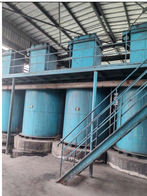
炭黑仓仓顶除尘器
