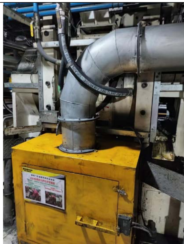
混炼室密闭、液体物料密闭管道输送
