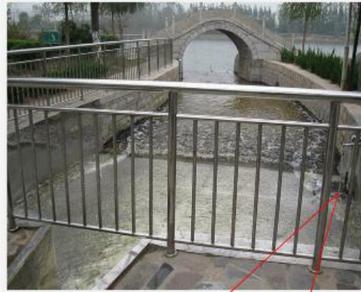
采样探头靠近明渠一侧，在污水流量较小时，采集不到水样。
