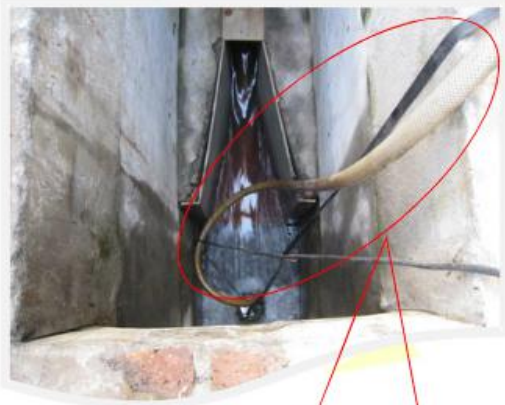
采样管路未固定，且采用软管。
